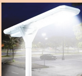
Nouvel éclairage led avec panneau solaire intégré, route de Cordes.
